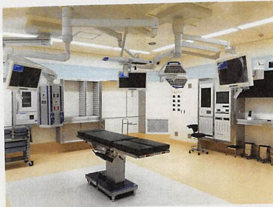
図1 新手術室の天井り26型HDモニターと壁面パネル
